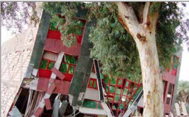
شکل ۱۴: ریزش قطعات سنگ پلاک
