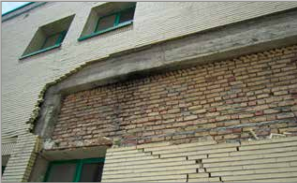
شکل ۱۳: ریزش قطعات آجر نما
