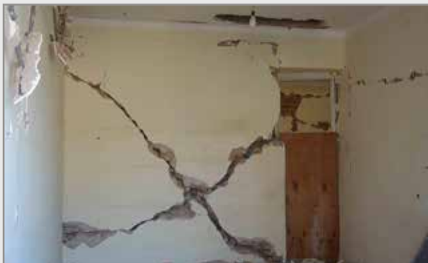
شکل ۱۲: شکست انفجاری دیوار بنایی
