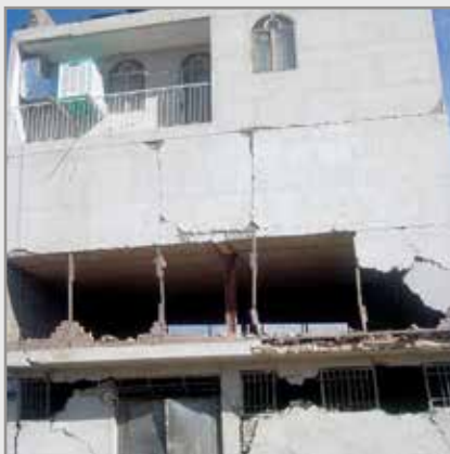
شکل ۳: انهدام خارج از صفحه دیوارهای بنایی
