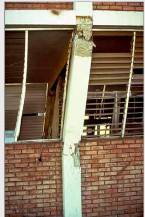
شکل ۸: شکست ترد برشی در ستون بتنی
