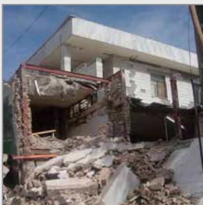
شکل ۴: تخریب کل ساختمان بر اثر فروریزی دیوارهای بنایی
