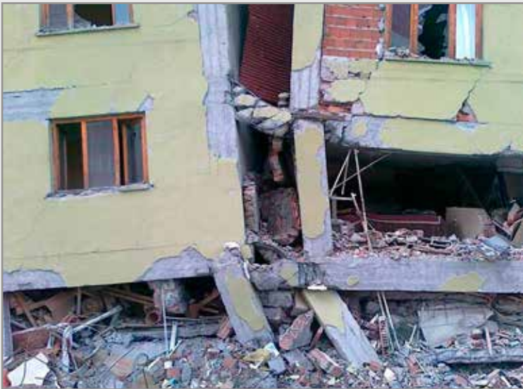
شکل ۷: تخریب ساختمان در اثر طبقه نرم زیرین
