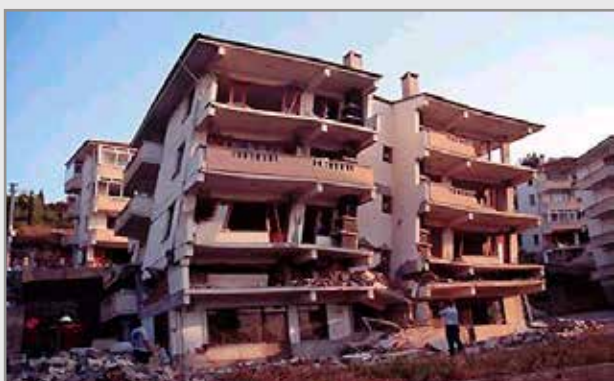
شکل ۱۰: تخریب در اثر حرکت پیچشی ساختمان
