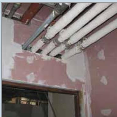
عدم رعایت الزامات کد حریق
