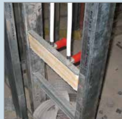
عدم اجرای صحیح جزییات روشویی
